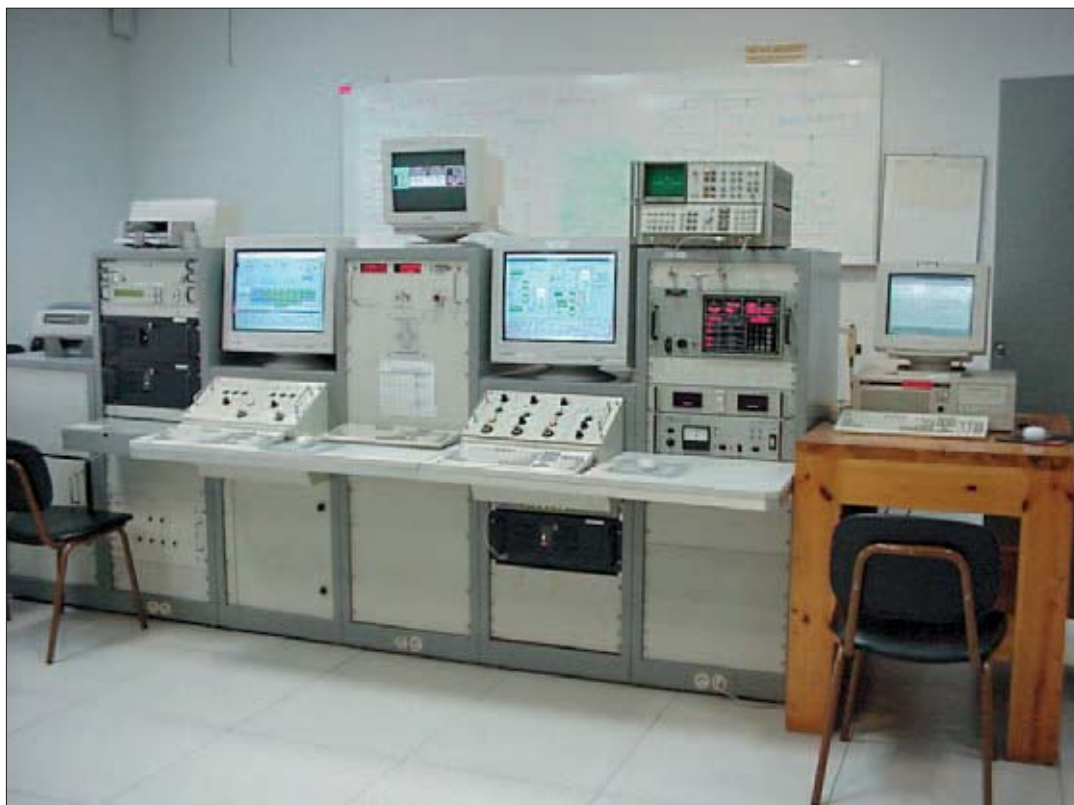
Consola de "Manutenção e Controle" de uma estação Satélite instalada na escola.
