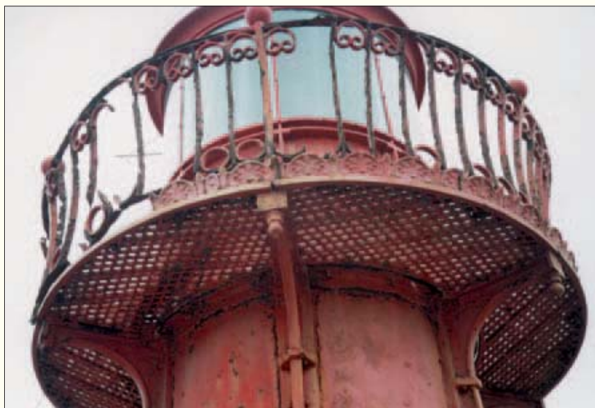
Varanda do Farol mostrando o seu estado degradado.
