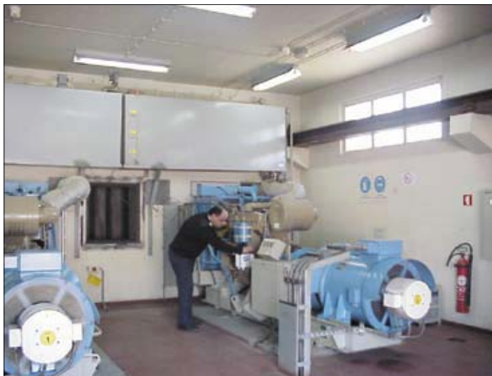
O 1SAR E Pires efectuando as rotinas de manutenção dos geradores.
