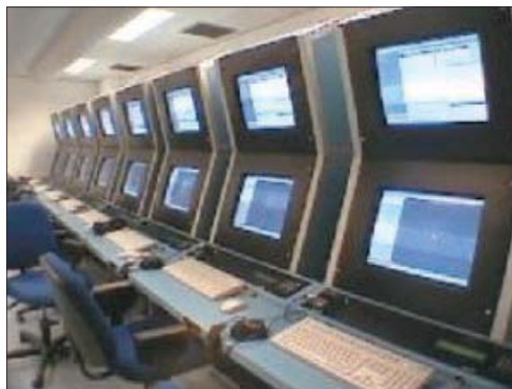
Fig. 8 - Exemplo de consolas multifuncionais dos cubículos do ASTT
